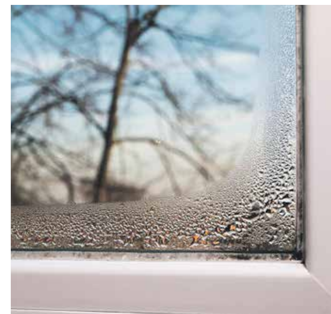
Las humedades por condensación son frecuentes dentro del hogar.
